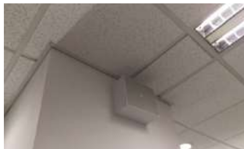
圖 181 網路喇叭安裝完成
