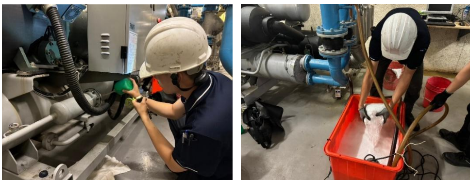
圖 202 空調冰水主機維護保養
