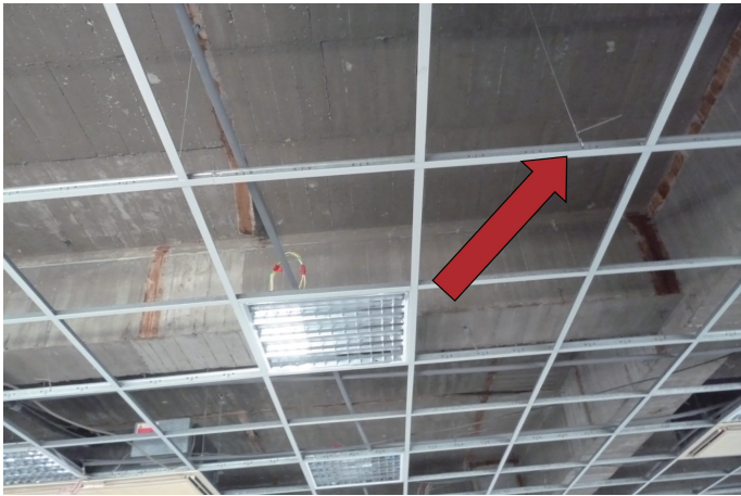
圖24 吊筋號數不符規定且距離牆面太遠
