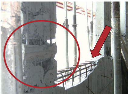
圖3 震動搗實不佳混凝土有蜂窩及孔洞
