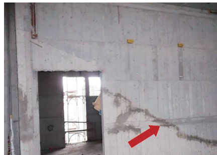
圖4混凝土澆築未妥善規劃有冷縫產生
