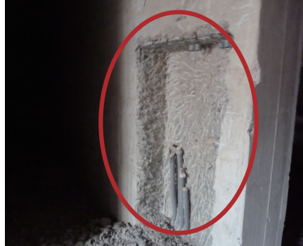
圖6 土建跟機電未整合致需打鑿混凝土
