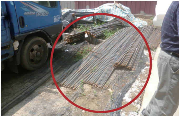
圖12 鋼筋堆置未架高及覆蓋保護
