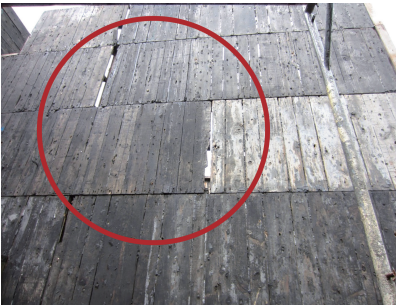
圖22 模板使用過度品質不良破損
