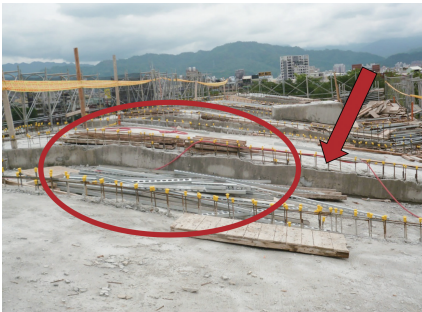
圖1 高程未確實控制致完成面水平度不佳
