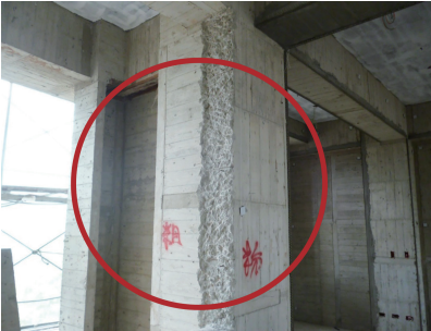
圖20 模板支撐未緊束及支撐勁度不足致爆模
