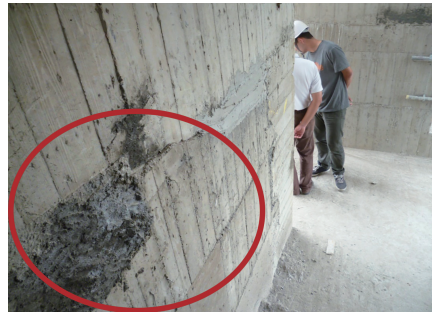
圖2 放樣未確實致完成面垂直度不佳產生錯位情形
