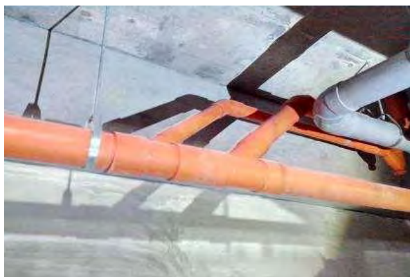
排水管直接由主幹管上端銜接錯誤工法
