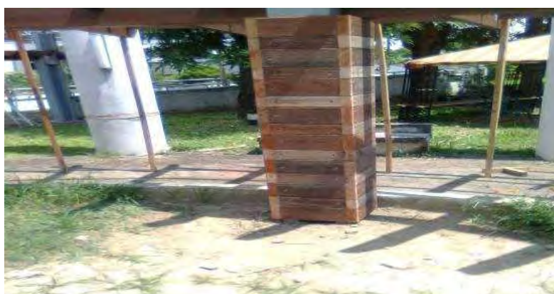
木製外飾包板使用於錯誤位置與固定方式造成更易腐朽
