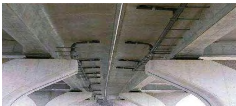
高架橋排水管直接以90度銜接主幹管實例
