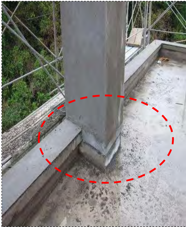
屋頂泛水施作未連貫之缺失
