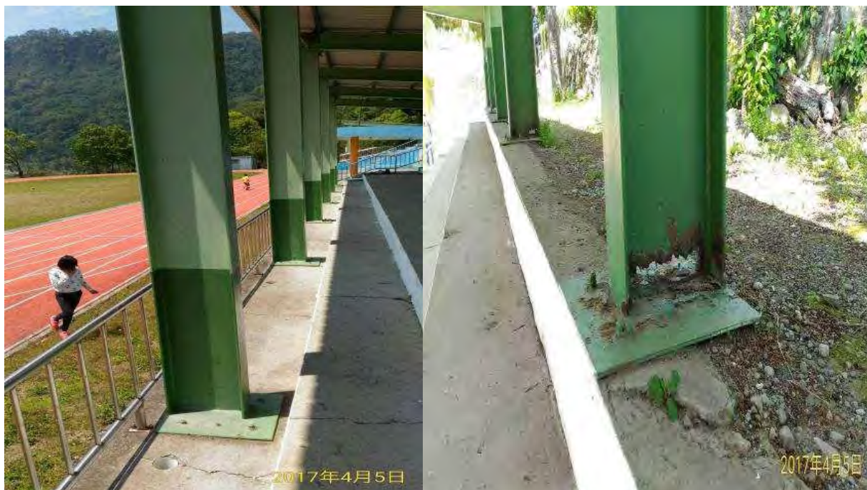
泰安鄉象鼻村鋼構固定方式錯誤未如木構造抬高固定態樣
