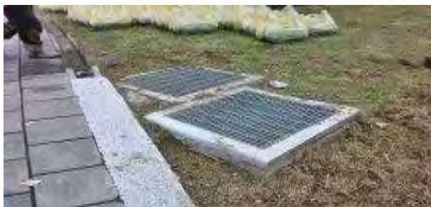
陰井高程控制不良無法發揮功能
