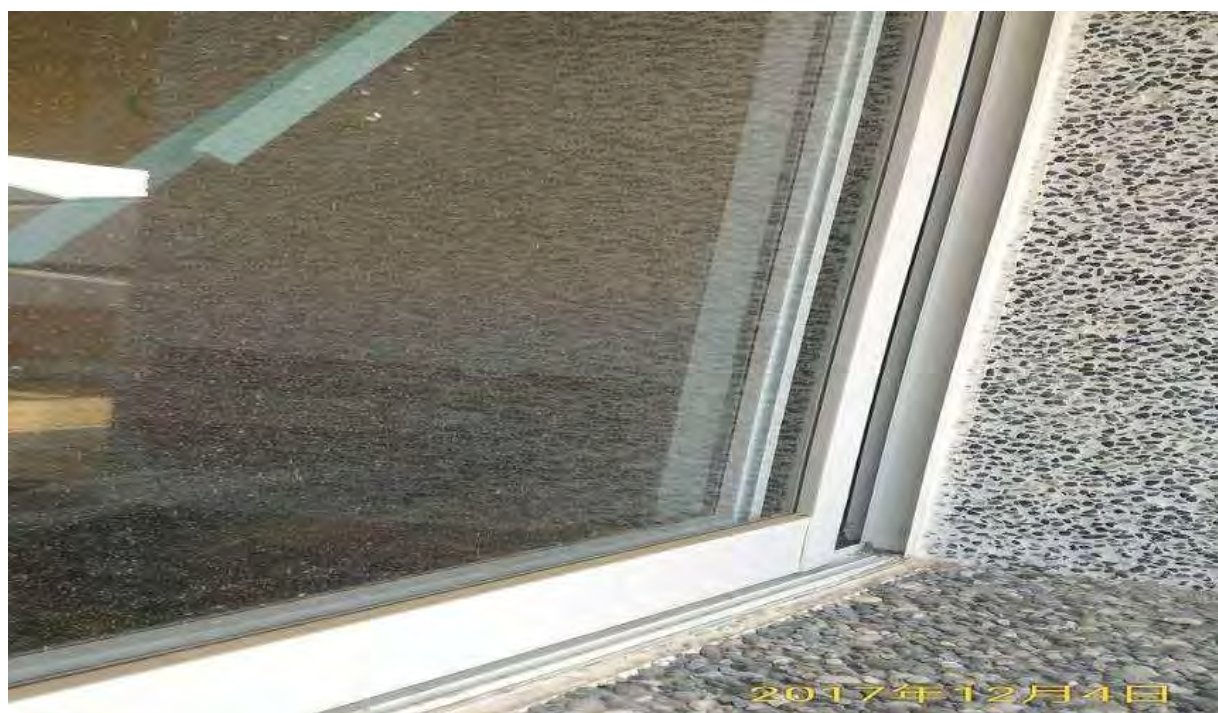
窗框邊未預留塞水路
