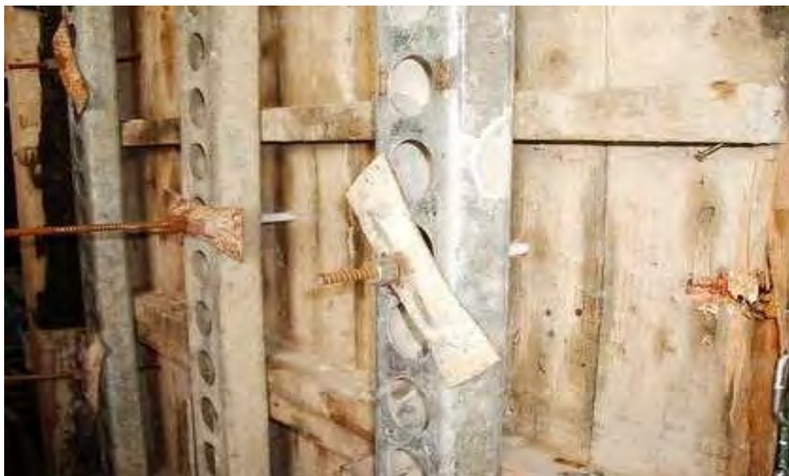
模板螺栓桿件加塑膠管之不當工法
