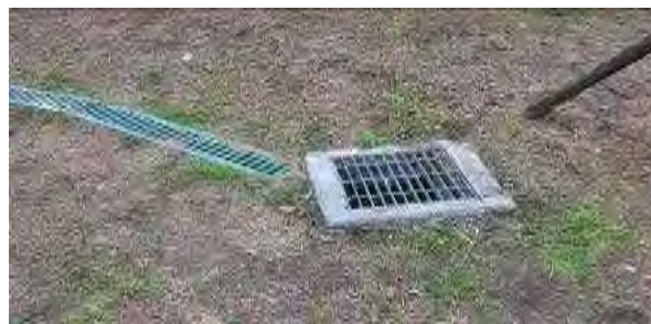
陰井設在斜坡且高程控制不良無法發揮功能
