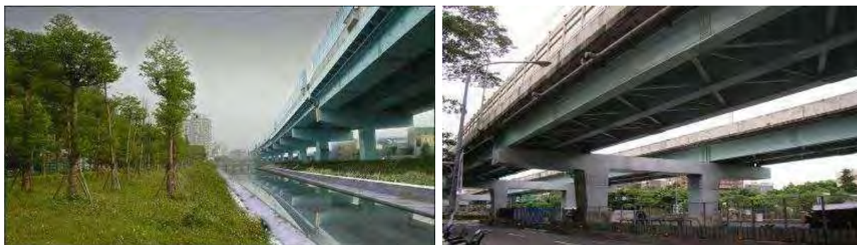
高架橋排水管直接以90度銜接主幹管實例
