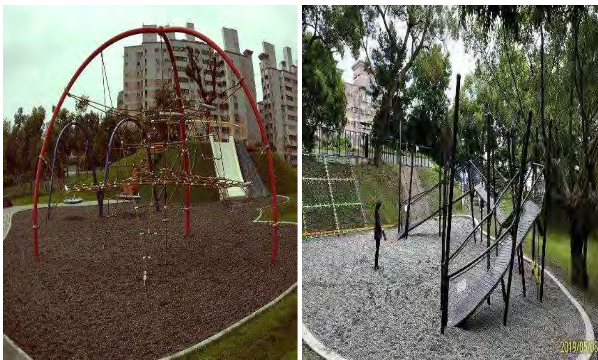
兒童遊憩設備鋼構固定方式錯誤未如木構造抬高固定態樣
