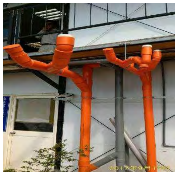
基本配管工法展示通氣管錯誤實例
