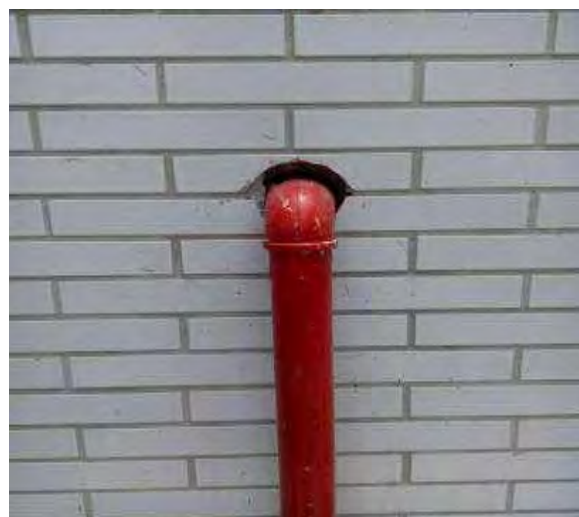
外牆未做過牆管又未妥善填充施做防水措施之實例
