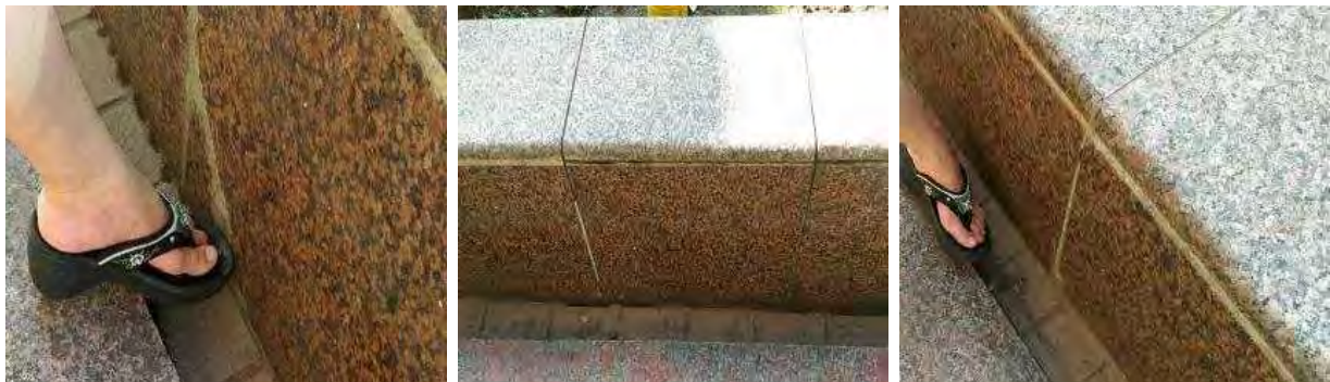
台北車站導水溝設計寬度深度不合尺度易生人身危險之實例
