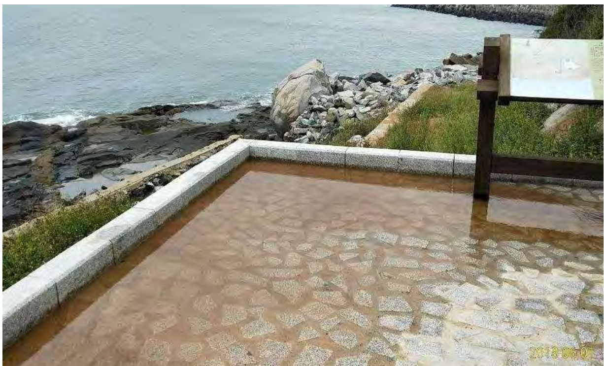
金門烈嶼四維六營區觀景平台未設計排水遇雨積水實例
