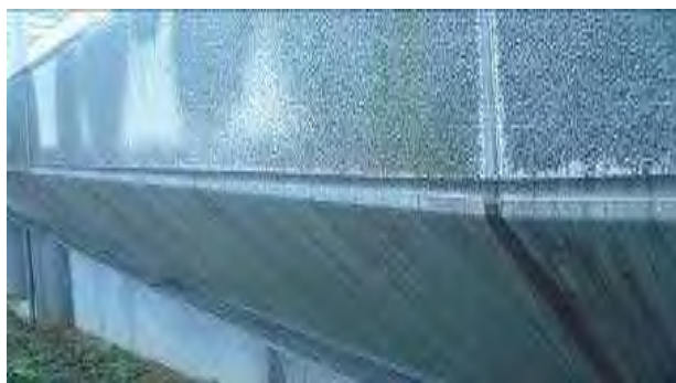
坡道下側細部未考量滴水線收頭
