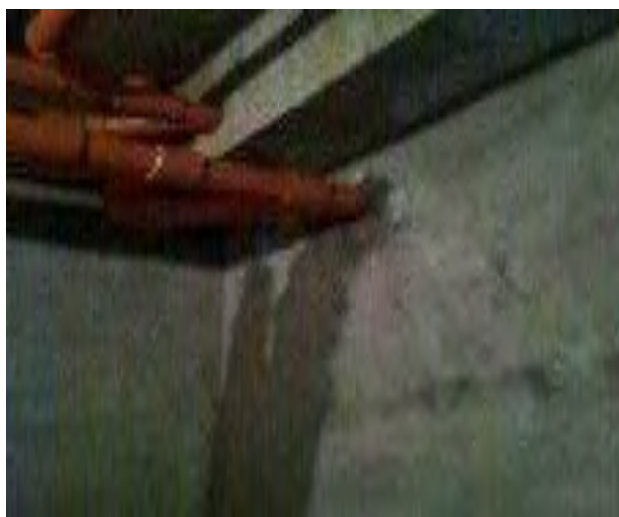
地下室外牆未做過牆管之滲漏實例
