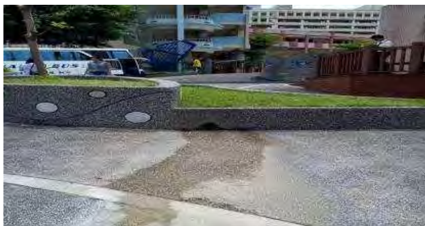
花台排水未考量截水溝水四處漫流污染鋪面實例
