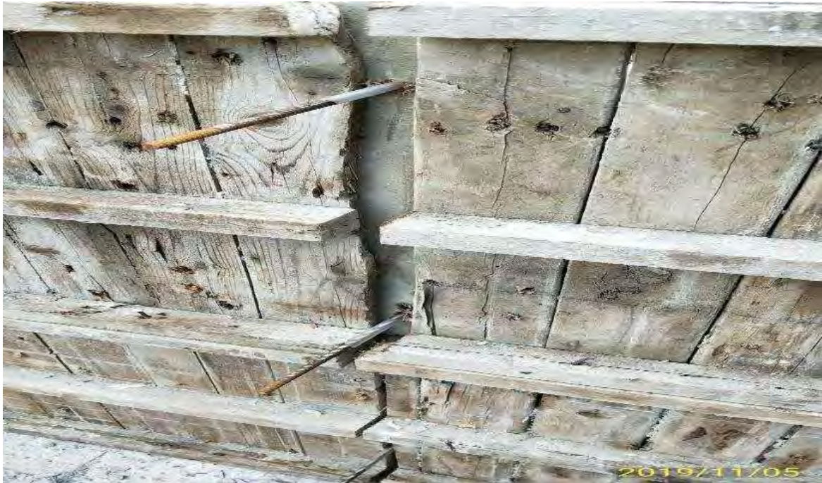
模板螺栓桿件加塑膠管之不當工法
