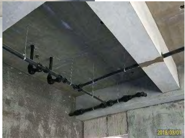
排水管由主幹管側邊接入未以30度順接工法且直接穿越量保護層之錯誤範例
