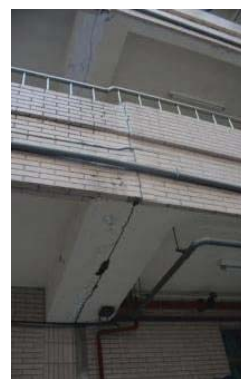
勘災結果：鄰棟伸縮縫破壞
