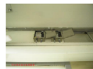
1F右側走道冷氣電錶箱
