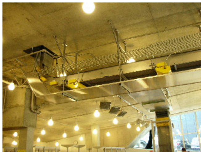
圖六四：1 樓的輸送管道會自動將還書送到 2 樓的整理室
