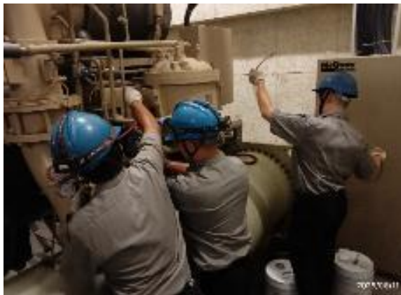
圖 214 空調冰水主機維護保養
