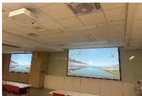
圖 238 第一會議室安裝雷射投影機及投影布幕完成汰換
